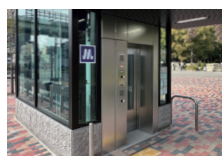
中央線 森ノ宮駅 エレベーター
